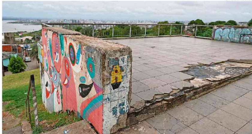
Situado em área de preservação permanente, espaço tem vista para o Guaíba. Piso está danificado
